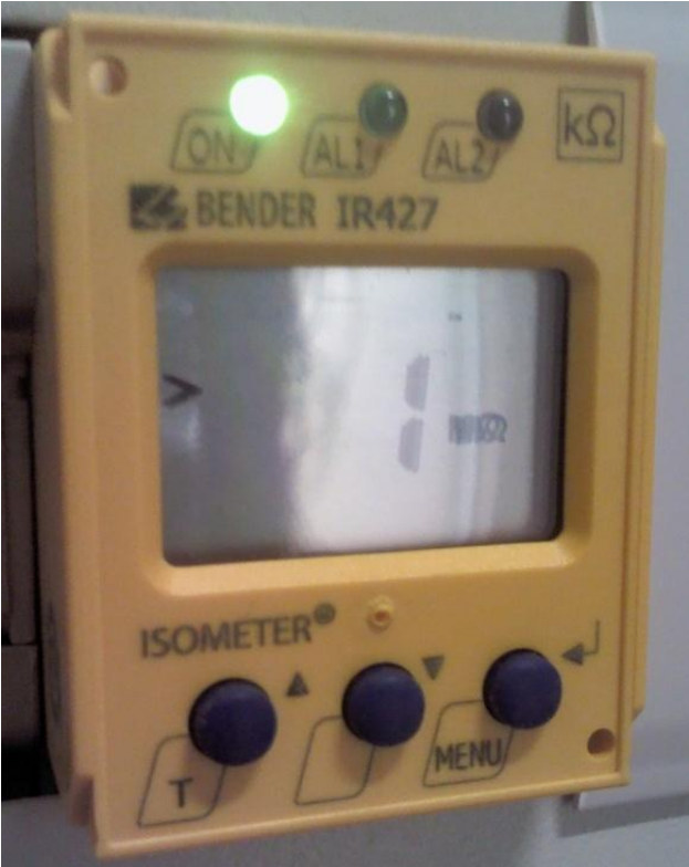
Detector de fugas en un cuadro eléctrico
